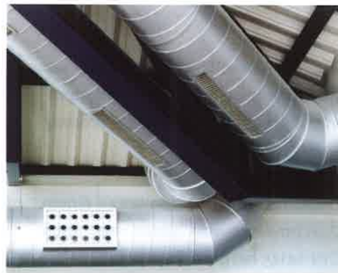
Wickelfalzrohr mit eingebauten Lüftungsgittern
